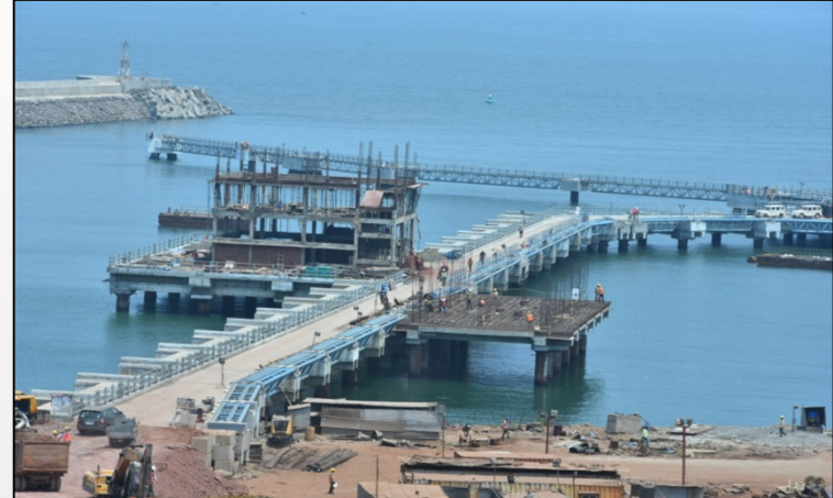
LNG Terminal at Jaigarh
