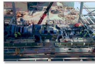
1390MW WAAD AL SHAMALSCCPP, SAUDI ARABIA ETC OF HRSG
