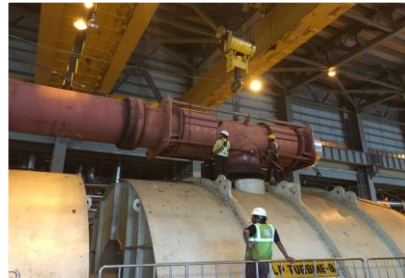
TURBINE AOH, 600 MW UDIPI
