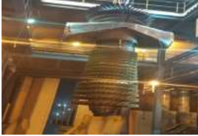
SIEMENS -138MW GAS TURBINE PAGUTHAN
