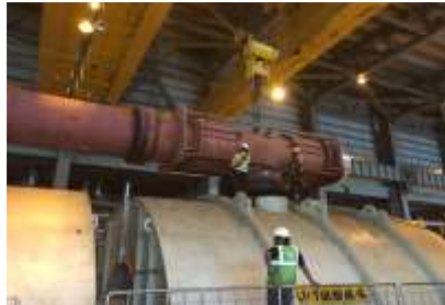
TURBINE AOH, 600 MW UDIPI
