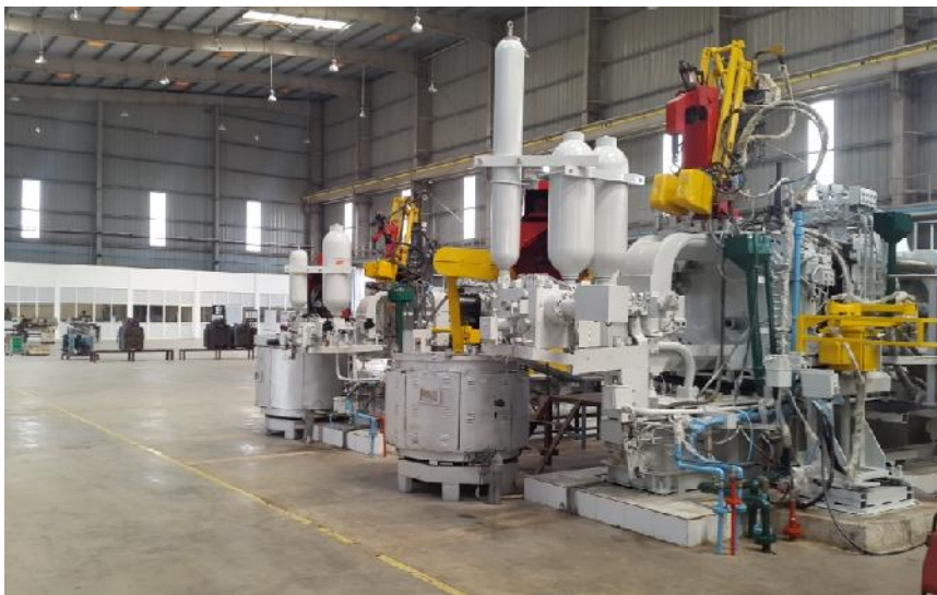
Die Casting Cell
